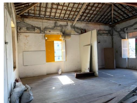
Sala de aula danificada
